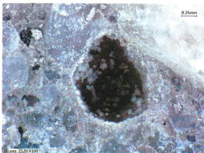
Fot. 28. Próbką 1118/19 – górna warstwa betonu, widoczny jest por powietrzny [7]
